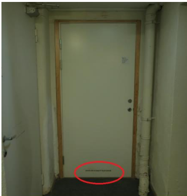
Figur 12 Gjennomhullet dør til bod
