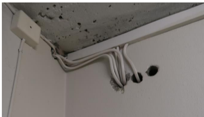
Figur 13 Eksempel på mangelfull brannetting
