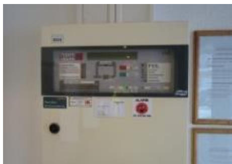
Figur 15 Brannalarmsentral i 1. etg.
