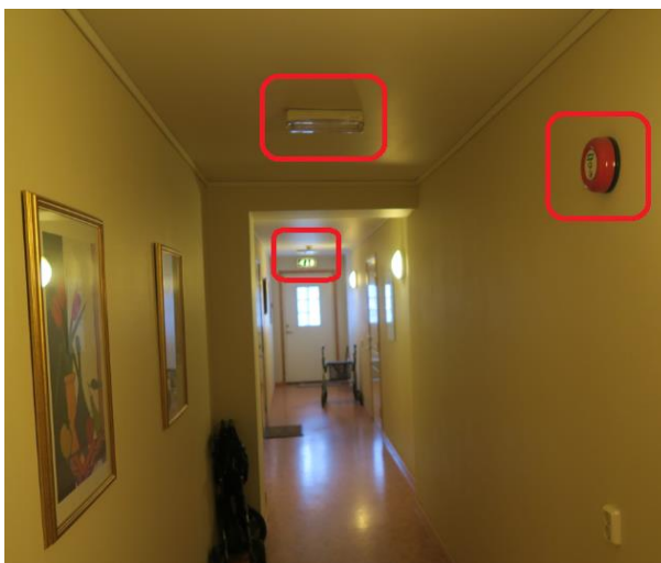
Figur 17 Korridor med nødllys, ledelys og alarmklokke
