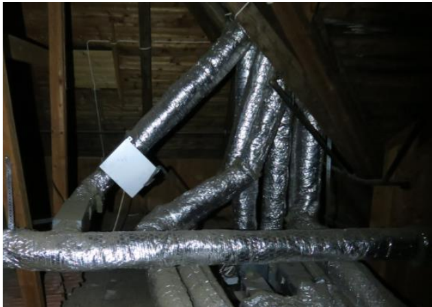
Figur 5 Isolerte ventilasjonskanaler på loft
